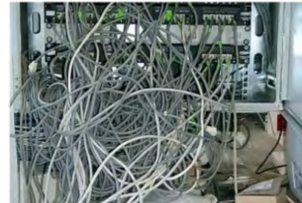
Baie de multiplexage
