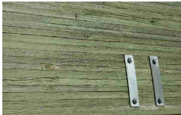
Délaminations, fissures et fentes [Doignon et al. 2009]
